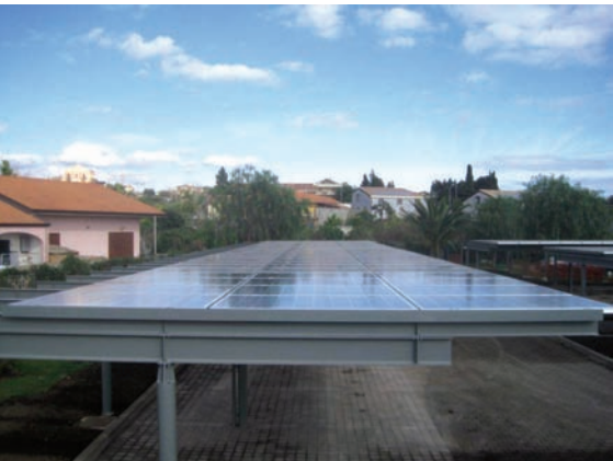
Pensilina fotovoltaica impianto di Acireale - via Sclafani
